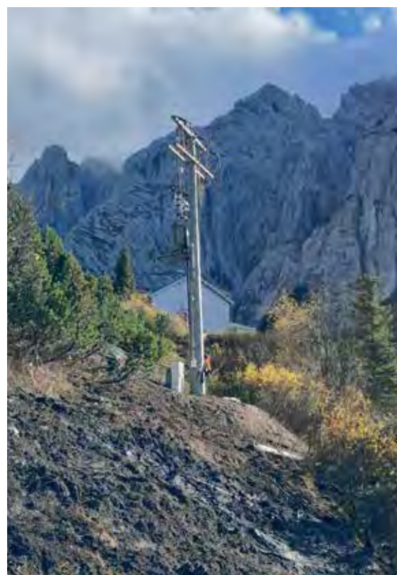
Masten aus Stahl sorgen bei Schlüsselstellen für zusätzliche Stabilität.
