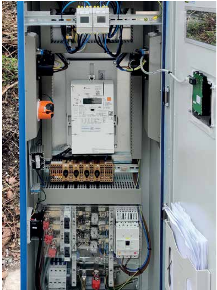
Das Innenleben einer Elektro-Ladesäule ist komplexer, als man vermuten könnte.
