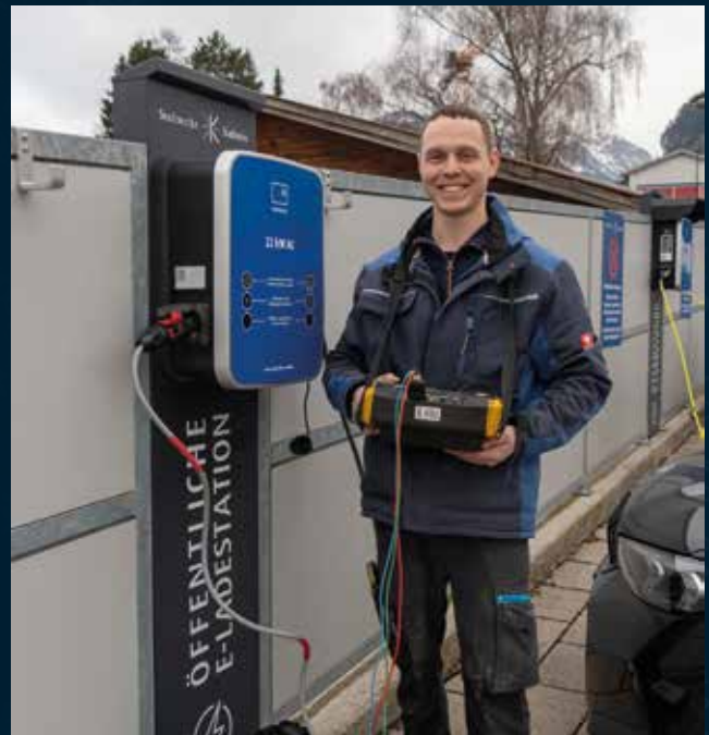
Martin Juffinger bei der Überprüfung einer öffentlichen E-Ladestation.
