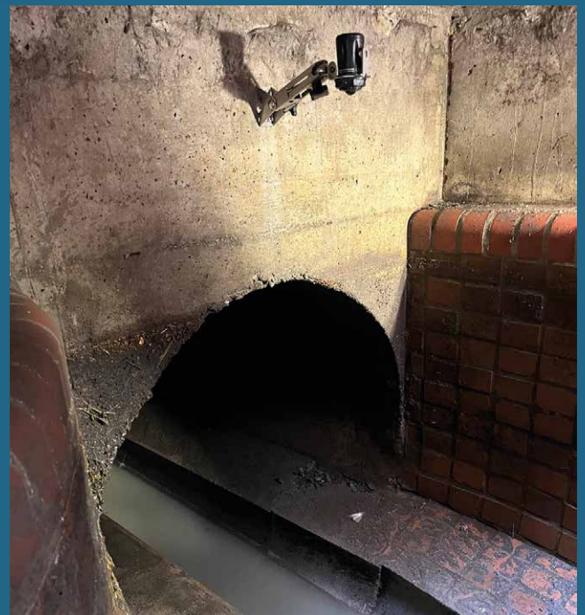
Radar-Sensoren erfassen den Füllstand im Abwassernetz.
