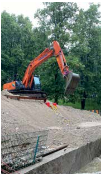
NACH DEM HOCHWASSER im Juli 2021 war der Spielplatz in der Kienbergstraße von Schutt und Sand begraben.
