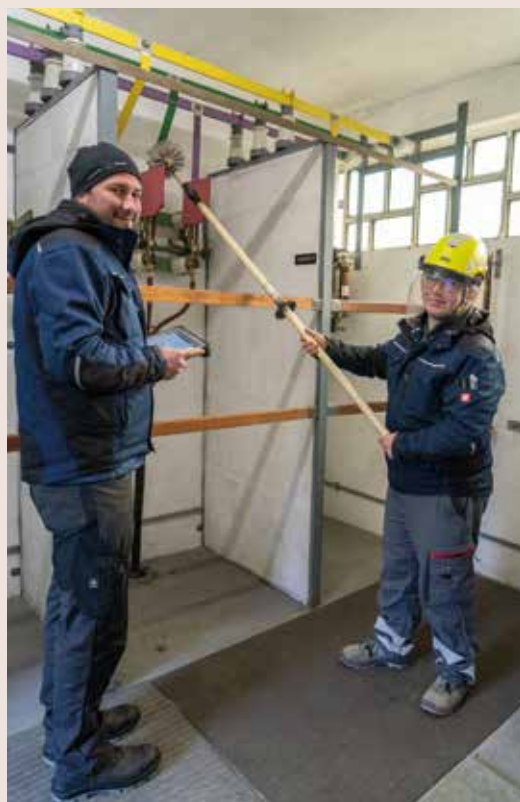
Robert Kronthaler und Rene Lamplmaier reinigen regelmäßig die Schaltanlage.
