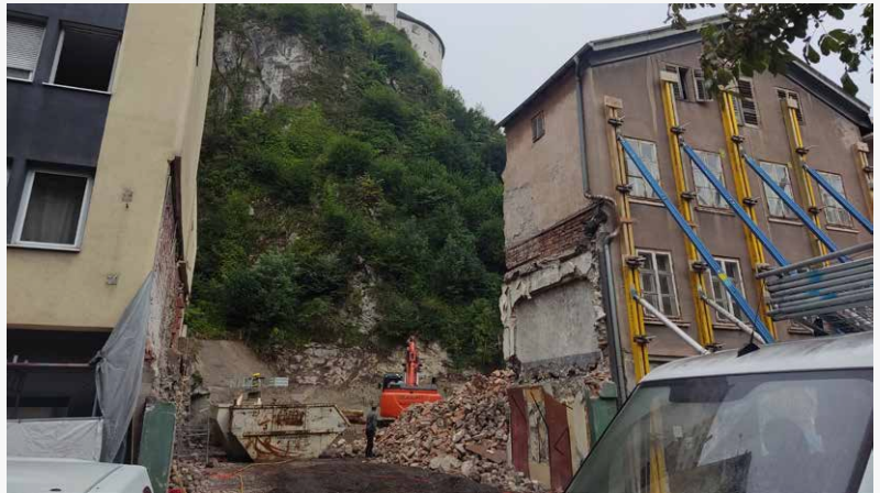
Das Bauprojekt in der Kinkstraße und die damit verbundenen Abbrucharbeiten machten die Totalsperre der Straße nötig.
